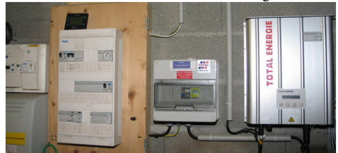
Die Zähler und der Wechselrichter der Solarstromanlage
