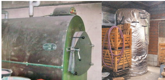
der Holzheizkessel (li.) und der Speicher (re.)
