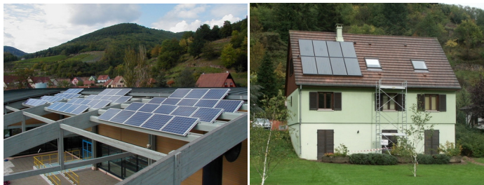
links : Solargeneratoren ; rechts Sonnenkollektoren des Espace nautique von Kaisersberg, rue du Geisbourg; Fotos CCVK
