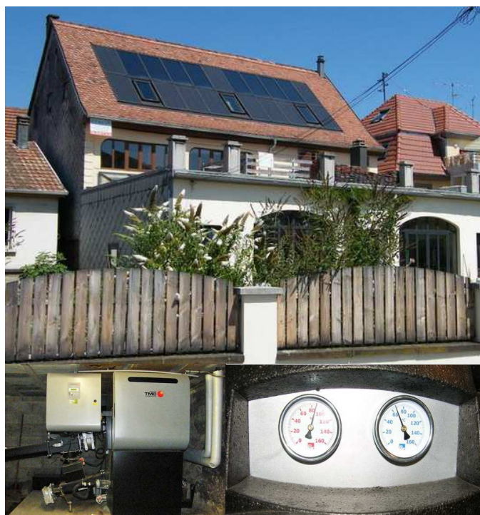
la chaudière à plaquettes ; le solaire en plein travail
