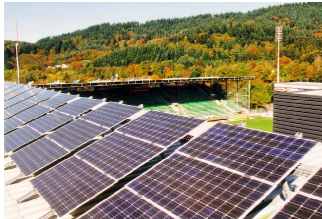
Centrale solaire Regio 94 kW c au Sportclub Freiburg, photo fesa e.V.
