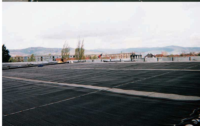
Moquette solaire sur le toit du stade nautique de Colmar
