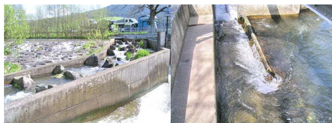
gauche : la rampe rugueuse et une partie de la passe à poisson droite : un courant d'attrait particulier attire les poissons depuis le peigne (centre de la photo) vers la gauche, dans la passe à poisson.
