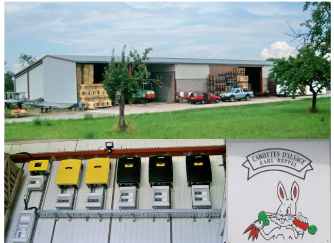
Le <hangar photovoltaïque> EARL REPPEL et ses onduleurs
