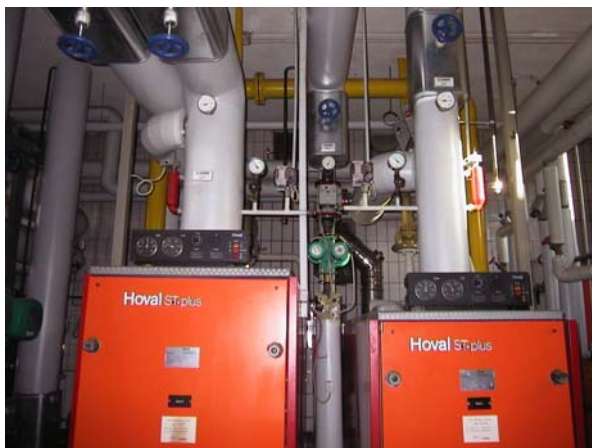
Bild 5: Kesselanlagen Bestand Offenburger Str. 49
