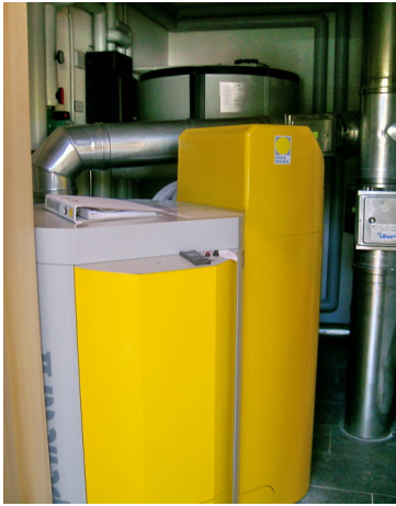
Pellet-Heizkessel 1 als Schauobjekt
