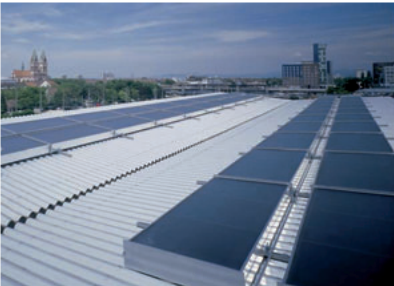
Abbildung 2: Kollektorfeld auf dem Dach der IHK Südlicher Oberrhein
