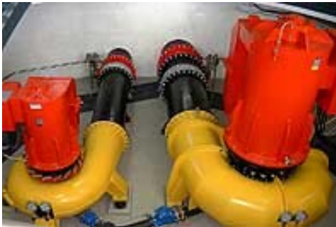
Abb. 5.4: Die beiden Francis-Turbinen mit vertikaler Wellenlage im Krafthaus der Turbinenfabrik.
