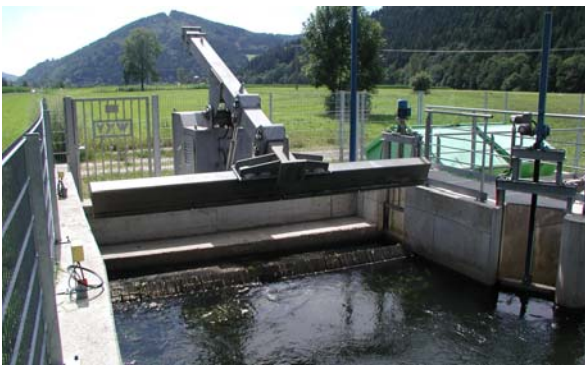
Abb. 5.3: Rechenreinigungsanlage mit Geschwemmsel-Spülrinne
