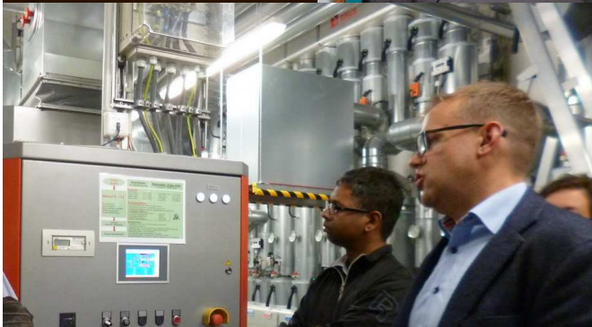
28./20.10. oben li. + unten: BHKW 50 kWel beim Badenova-Neubau, mit Ingenieur Stefan Eckstein, Leiter Gebäudemanagement Badenova AG. Oben re. Bauverein Breisgau Modellprojekt (Innovationsfonds Badenova) Emmendingerstr. 16-34, Freiburg, mit Ewald Zink, TGA-Planungsgruppe Freiburg, GF
