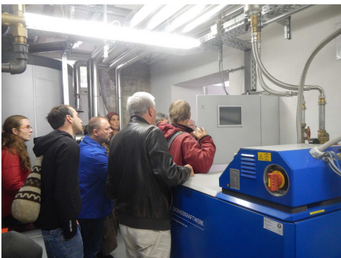
29.10.: MFH-Altbau - neues BHKW mit PV und Batterie. Freiburg-Wiehre. Mit Dr. Jörg Lange, Solares Bauen GmbH, Freiburg. Foto GL
