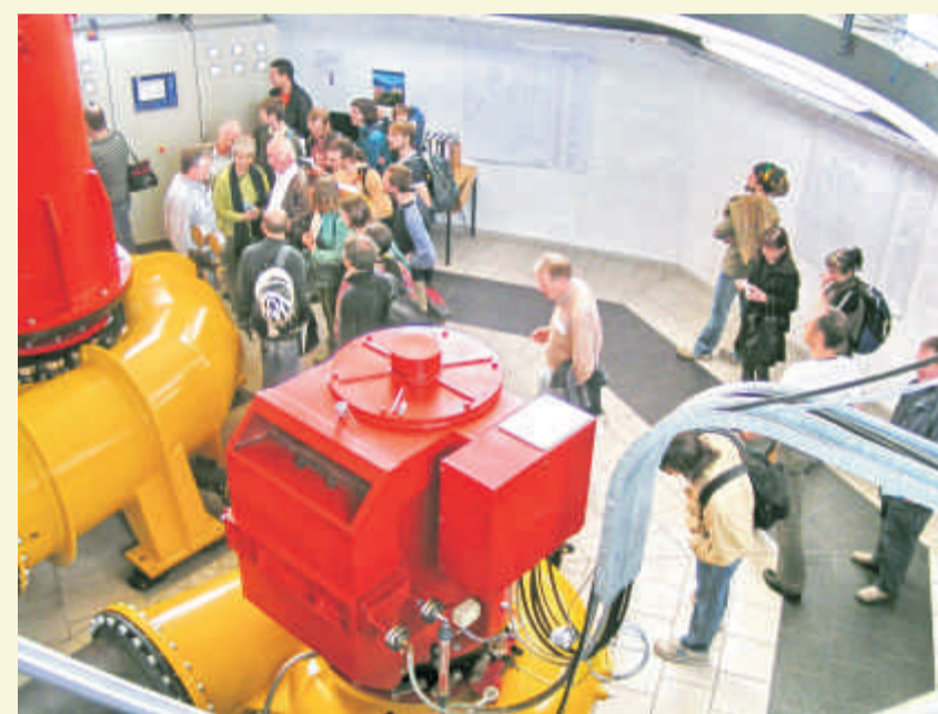
Zukunftsfabrik der Wasserkraft Volk AG, Gutach-Bleibach
