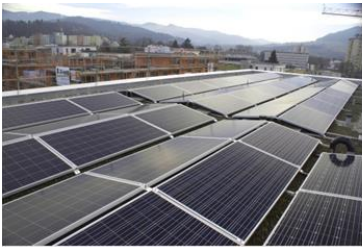
Photovoltaik (PV) auf Mehrfamilienhäusern
