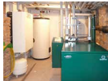
Strom erzeugende Heizung (Mini-BHKW) mit Eigenstrom für 4 Altbauten: spart 50% Primärenergie, bis 100% CO 2
