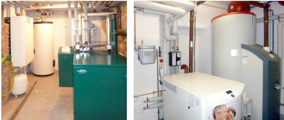
Abbildung 10 Vorbild-BHKW in Kellern, die bei Führungen besucht wurden
