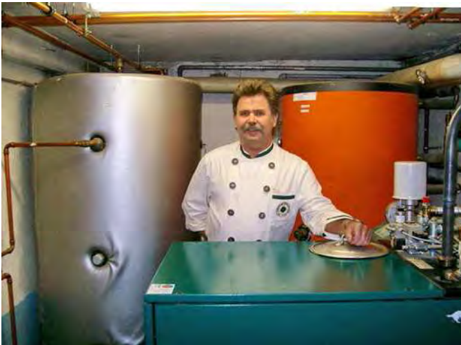
Löwen-Wirt Roland Birkenmeier, der Dachs, die Wärmespeicher, ganz oben: Hotel und Gästehaus
