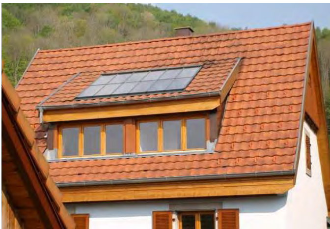
Sonnenkollektoren (oben), Solargeneratoren (unten)
