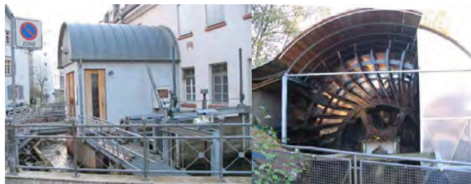
EM: Turbine EEE am Stadttor (li), Wasserrad EEE, Romaneistraße
