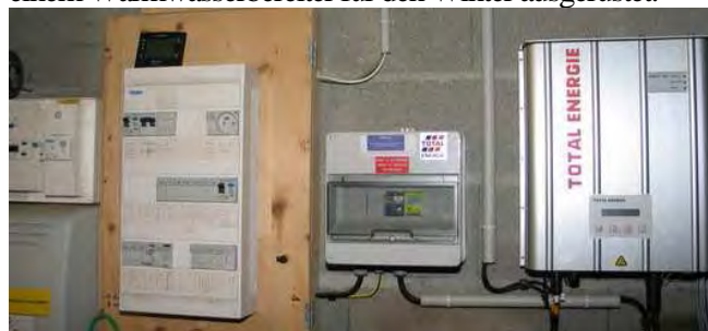
Die Zähler und der Wechselrichter der Solarstromanlage
