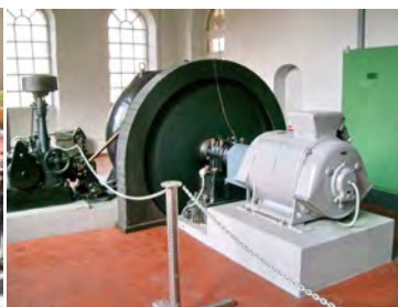
Generator und Schwungrad
