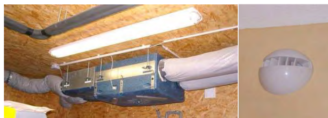
Wärmetauscher der Wärmerückgewinnung; Zuluftöffnung
