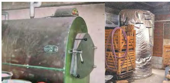
der Holzheizkessel (li.) und der Speicher (re.)
