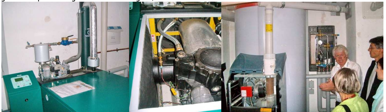
1. Foto von li.: BHKW (Dachs, Senertec, 5,5 kWel, 13-14 kWth, eingebaut von Kreuz GmbH, mit Gehäuse, Kontroll-Konsole (li) und Brennwert-Wärmetauscher (re. hinten), 2. Foto von li.: BHKW geöffnet, Generator Mitte li., Foto rechts: mit Joachim Kreuz vor dem Wärmetauscher (an der Wand ganz hinten re.) für Trinkwassererwärmung. Hinten links der Solvis-Schichtenspeicher (950l)
