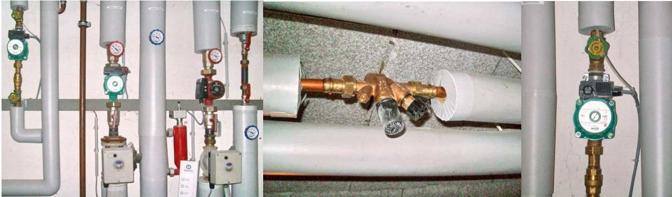
Pumpengruppe mit Hocheffizienzpumpen, mittl. Foto: Thermostatventil, ganz rechts: die Warmwasser-Zirkulationspumpe mit Sensor oberhalb
